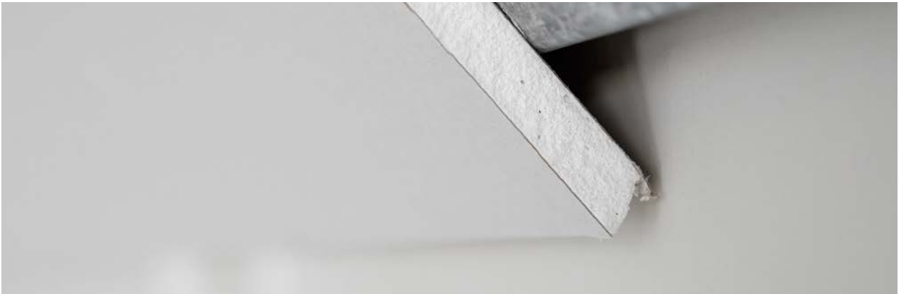
Ausgangssituation im Anschlussbereich zur Abseitenwand.
