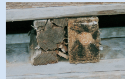
Zwei reparierte nebeneinanderliegende Kanthölzer (Abweichung von der Herstellernorm)
