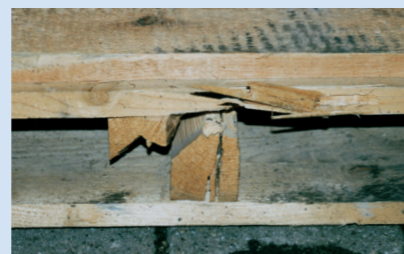
Kantholz angebrochen/ gebrochen
