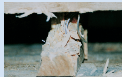
Kantholz so gesplittert, dass keine Nagelfestigkeit gegeben ist
